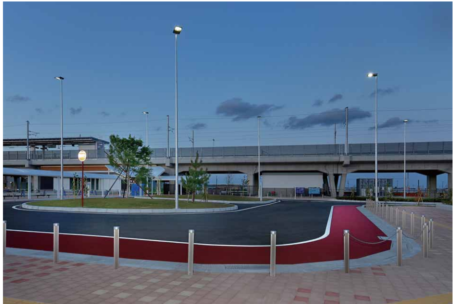
新山下駅前ロータリーの道路照明 地上10m高の新型LED道路灯を設置し、車の流れを円滑に誘導
