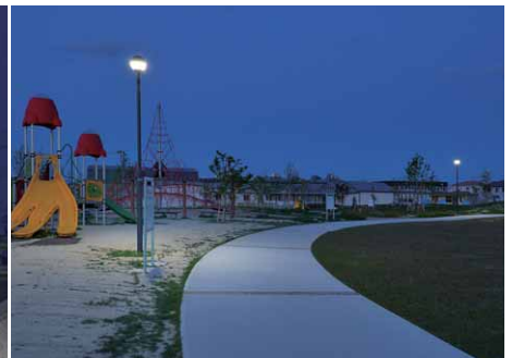
つばめの杜中央公園に採用された下方向重視の全方向配光形LED街路灯
