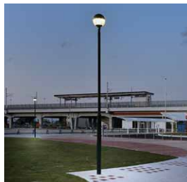
駅前広場に設置されたLED街路灯 (H=4.5m)
