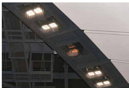
LED角形高天井器具と LEDスポットライトFORTEX(中央側)
