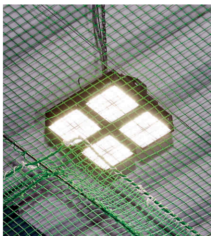
ワイヤーで吊るされたLED高天井器具
