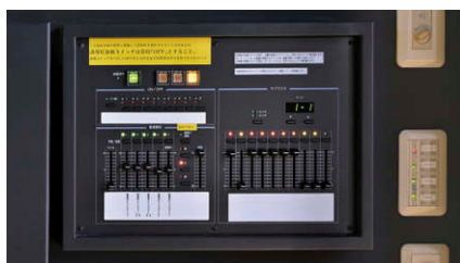
舞台袖用照明操作盤
