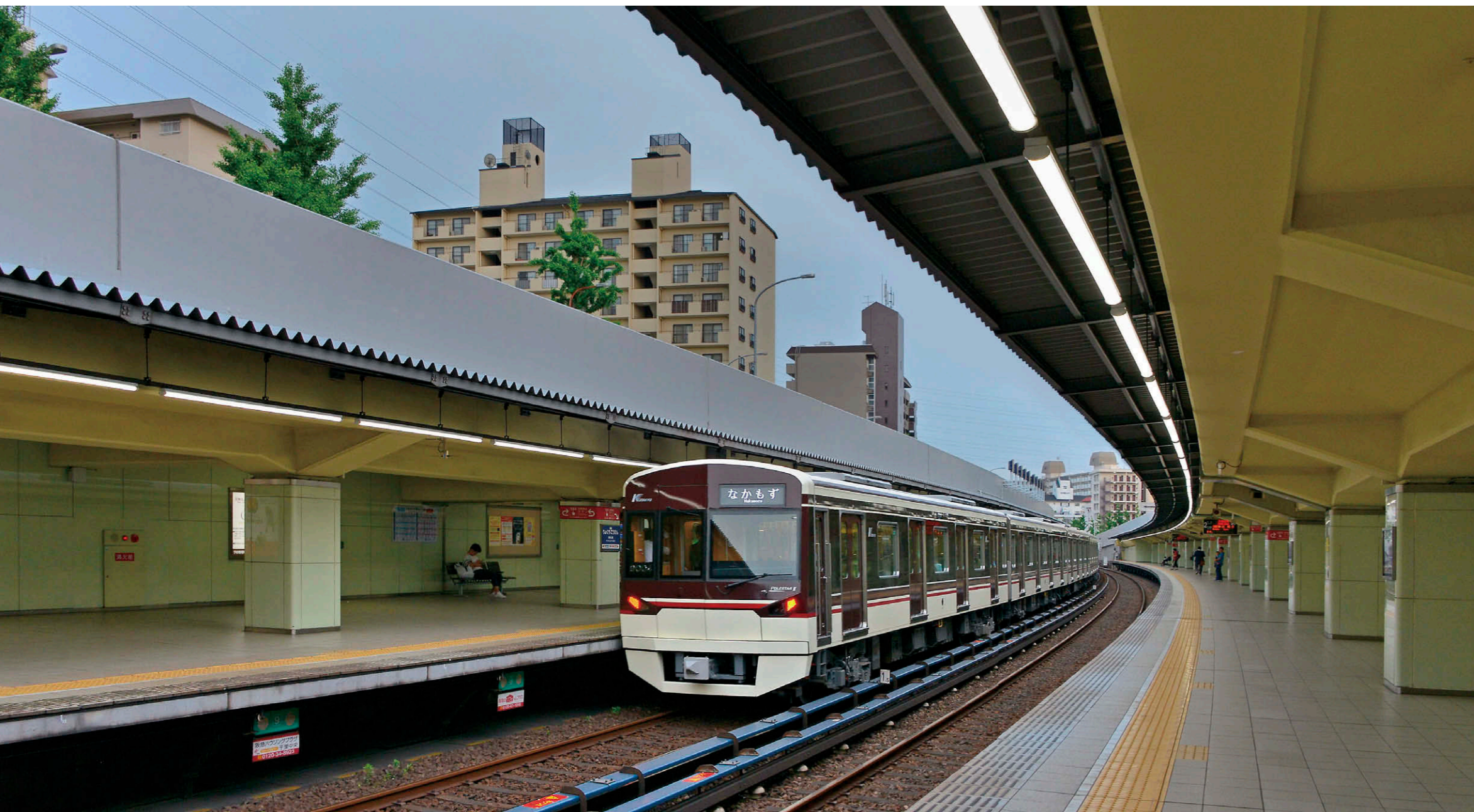
①ホーム乗降部の照明 TENQOOシリーズ防水・防雨仕様を既設器具のレースウェイに配置したホーム乗降部。2番線ホーム端から江坂方面を望む
