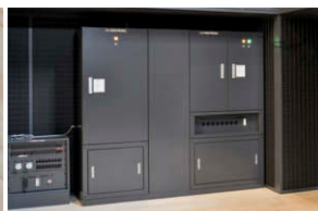
持込機器用電源盤
