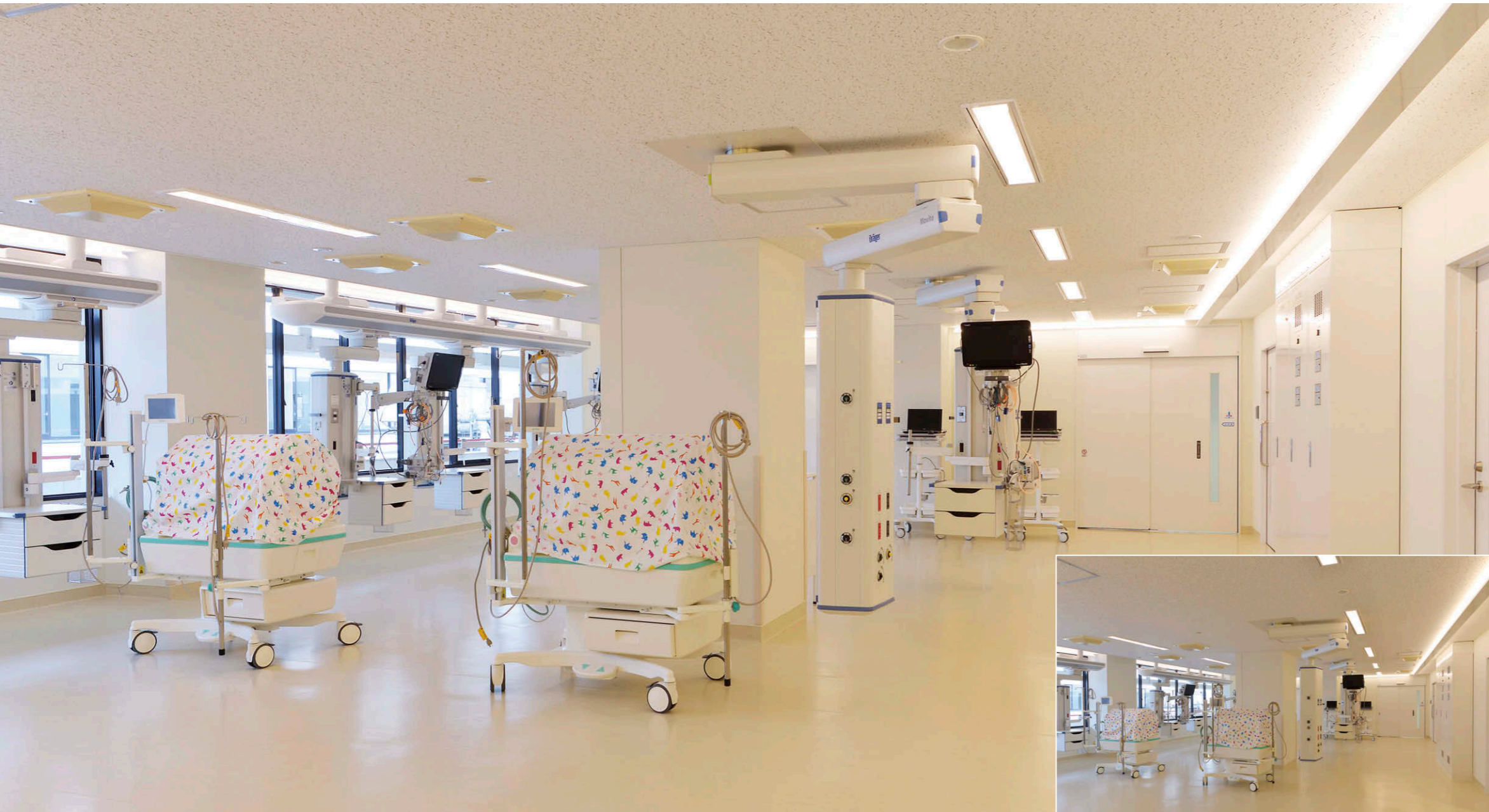
NICUの照明 LED2面配光間接光①②と下面アクリルパネル付きのTENQOOシリーズ埋込形③を照明コントロール(全点灯500ルクス、右下は300ルクス点灯)
