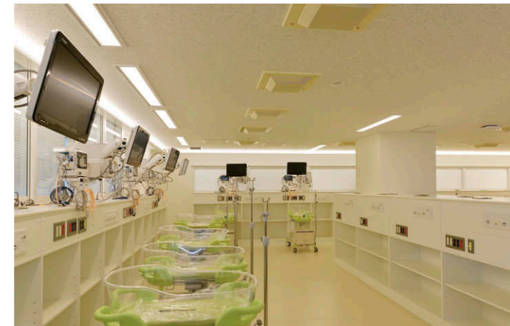
GCUの照明 LED2面配光間接光①②とTENQOOシリーズ埋込形③を配置
