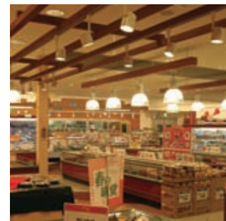
吊り物に設置されているハロゲンランプスポットライト
