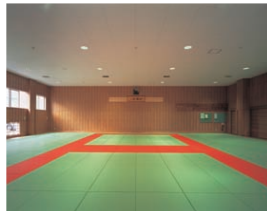
柔道場の照明：200Wメタルハイドランプ強化ガラス枠付埋込ダウンライトを採用し、全体に均一な明るさを確保
