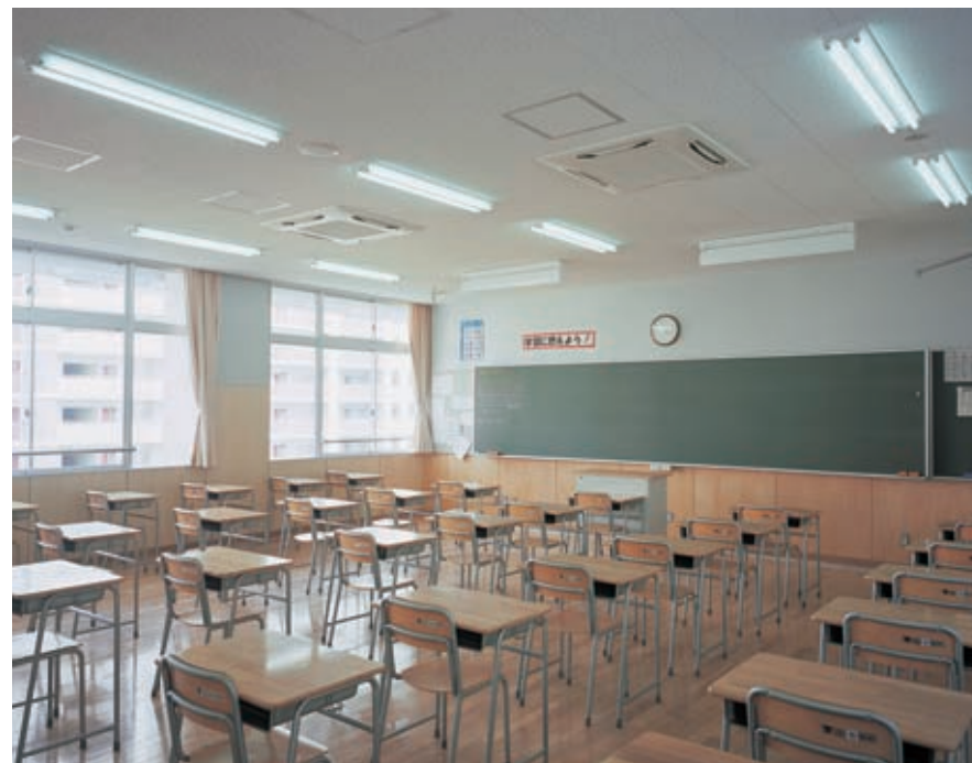
HR教室(全日制)の照明：32WHf蛍光ランプ2灯用逆富士形器具を黒板とクロスして配置
