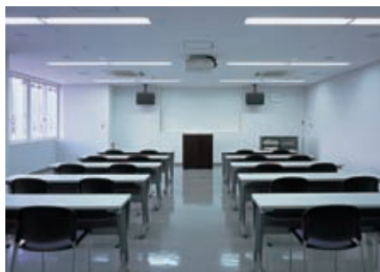
会議室の照明
