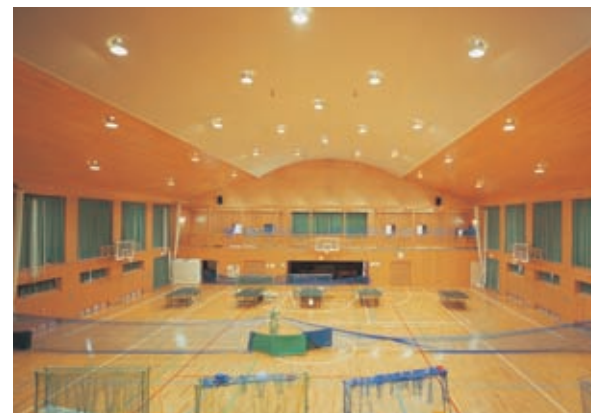
体育館アリーナの照明：400Wメタルハライドランプ高天井用反射器具を分散配置(電動昇降装置付)
