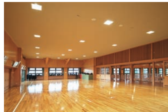
柔剣道場の照明：400Wメタルハライドランプ埋込器具(電動昇降装置付)を採用
