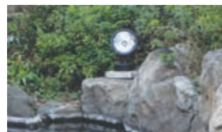
庭園の池周辺に設けられているCDM投光器
