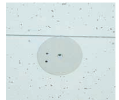
店内中央部天井に設けられた照明制御システムSESL 親機 Main SESL II lighting control system installed on the center ceiling in the store
