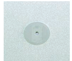
入口部天井に設置された照明制御システムSESL の子機 Terminal unit of SESL II lighting control system installed on the ceiling of the entrance of the store
