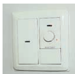
クリーン病室の調光用スイッチ Light-control switch for clean hospital room
