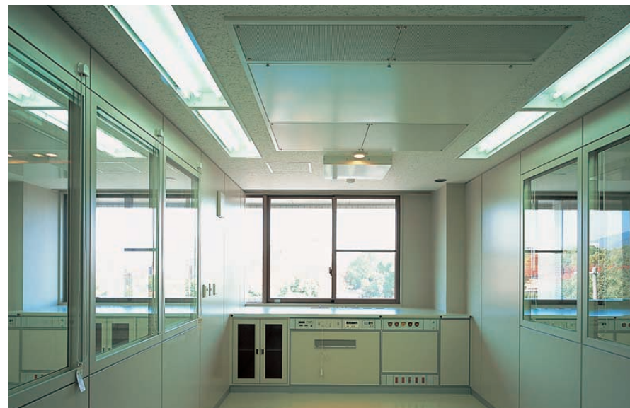
3階クリーン病室：40W2灯用クリーンルーム用埋込器具(調光)と90Wハロゲンランプ処置灯を配置し、適確な照明環境をつくり出している Clean hospital room on 3rd floor
