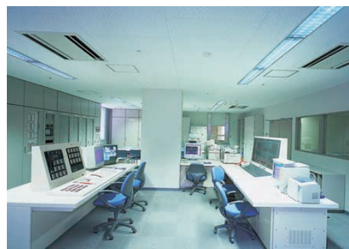
中央管理室：32WHf2灯用OA対応埋込器具を連結設置 Central control room
