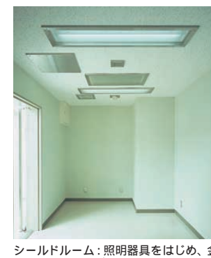
シールドルーム：照明器具をはじめ、金属メッシュでカバーし接地している Shield room
