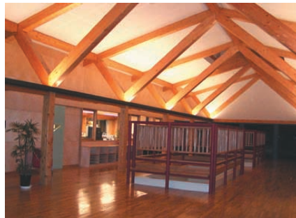
2階直路：FHP105W（電球色）間接照明器具を採用。
