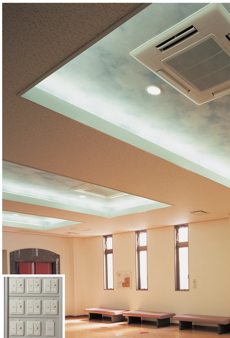
2階ホール：間接照明には40W蛍光灯ランプトラフ器具を設置。1階の事務室に設置されたコント
