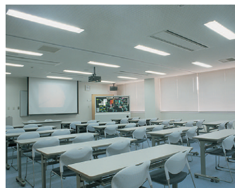
会議室：プロジェクターを使用するため、Hf32W2灯用白色バツフル付調光器具を整列配置。調光用にコントルクスを設けている
