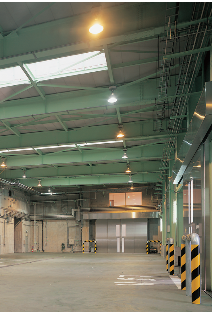
タルハイドランプと360W高圧ナトリウムランプの混光照明としている
