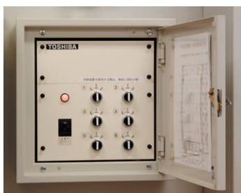
教官室にある昇降操作盤。 ラインごとの昇降も可能
