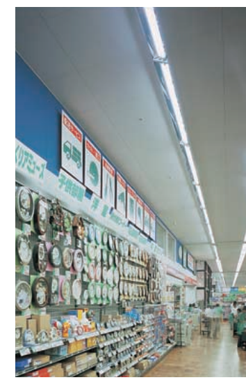
110W蛍光ランプウォールウォッシャーで壁面展示品の鉛直面照度を高めている
