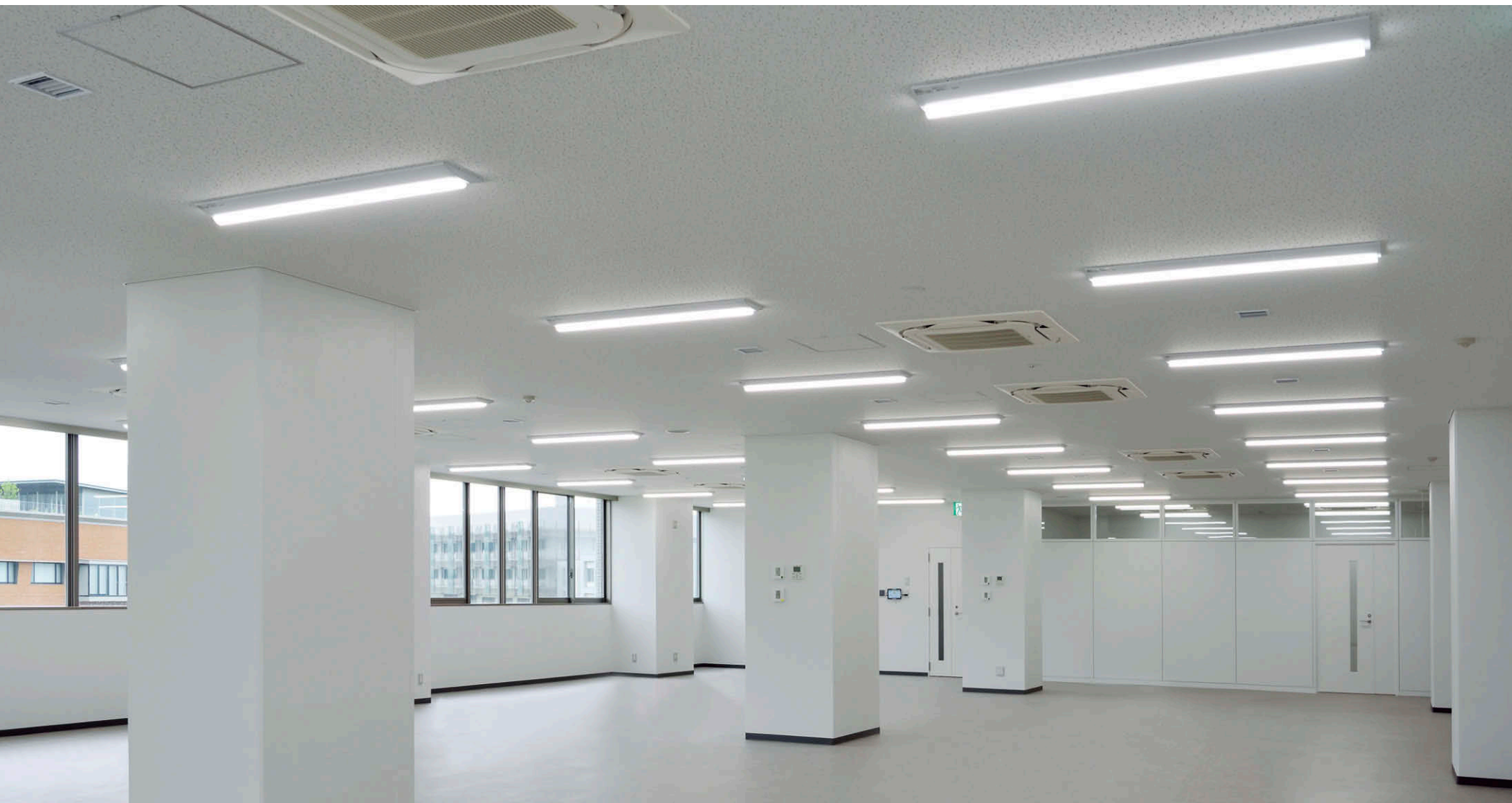
TENQOO無線T/Flecsシステムを採用し、レイアウト変更にもフレキシブルに対応可能とした1～4階の事務室の照明①。
