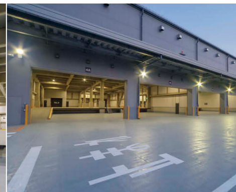
4階トラックバースの屋外照明 横長タイプ配光の LED 小形角形投光器⑤を出入り口上部壁面に配置。
