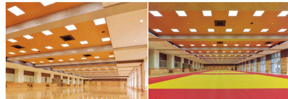
板張り武道場(左)畳敷き武道場(右)の照明 競技エリアにはTENQOOスクエア③を均等配置し、観覧席と窓際にはLED一体形ダウンライト④を配置。
