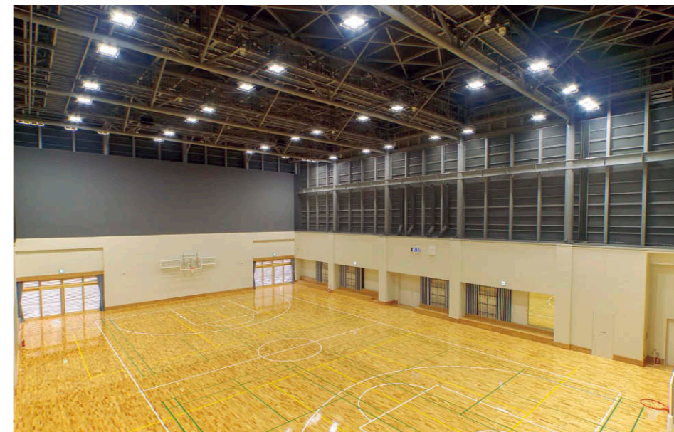
サブアリーナの照明 メインアリーナと同様、LED高天井器具(特注)①②を配置。
