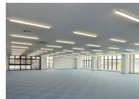
3階執務室 TENQOOシリーズ直付形昼白色①を均等配置。
