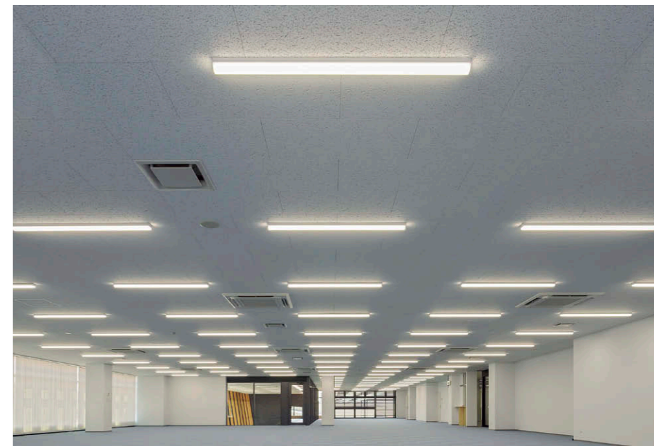
2階執務室 TENQOOシリーズ直付形昼白色①を均等配置。
