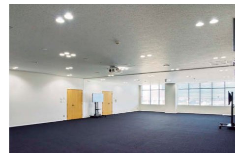
3階、大会議室のLEDユニット交換形ダウンライト④による照明。
