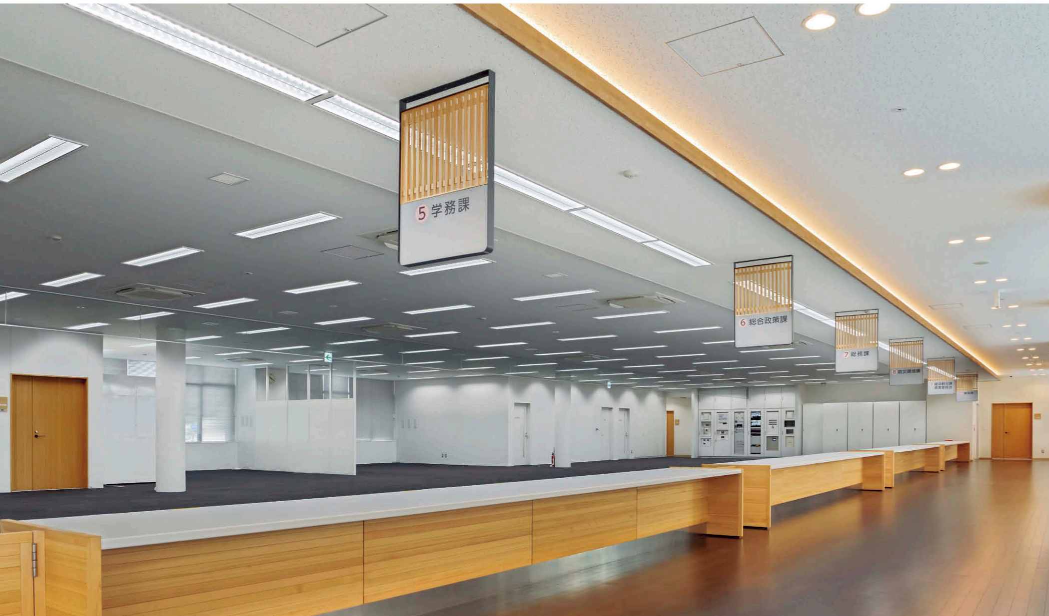
2階執務室の高性能人感センサー制御「T/Flecs」を採用したTENQOOシリーズ埋込形①②による照明。
