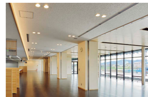
1階、待合スペースのLEDユニット交換形ダウンライト④による照明。
