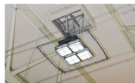
① LED 高天井器具に②2灯用拡散カバー付下面ガードを装着し2台一組として配置。
