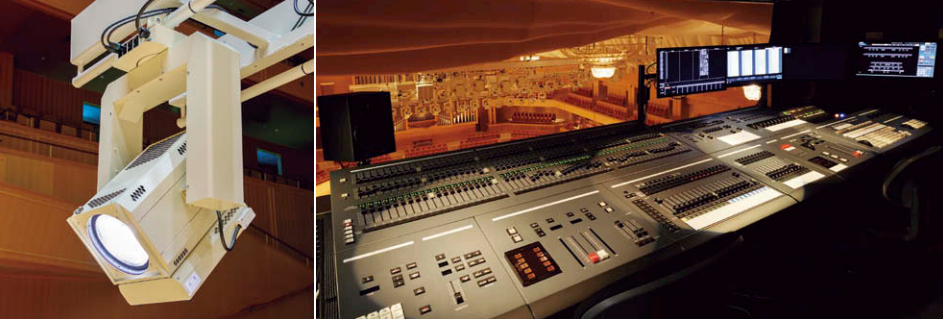
LED リモコンスポットライト③ コンサートホールの調光操作卓⑤
