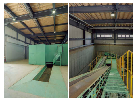
木くずの投入口側 (左) と木材チップの出口側 (右)
