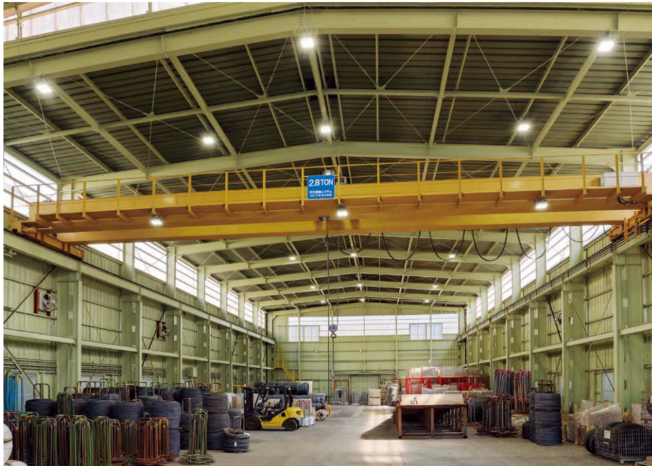
11m高の天井にLED高天井器具軽量タイプ(21台)を採用し、クレーン用には耐衝撃・耐震動対応の高天井器具を採用(3台) ①②
