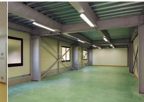
工場棟倉庫 梁下にLEDベースライト直付反射笠③を計10台配置。
