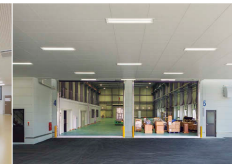
ピロティ 防湿・防雨タイプの埋込形LEDベースライト⑦を11台配置した設計室棟1階ピロティ。
