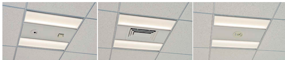
グリッドタイプの器具③に組み込まれた各種の設備機器。
