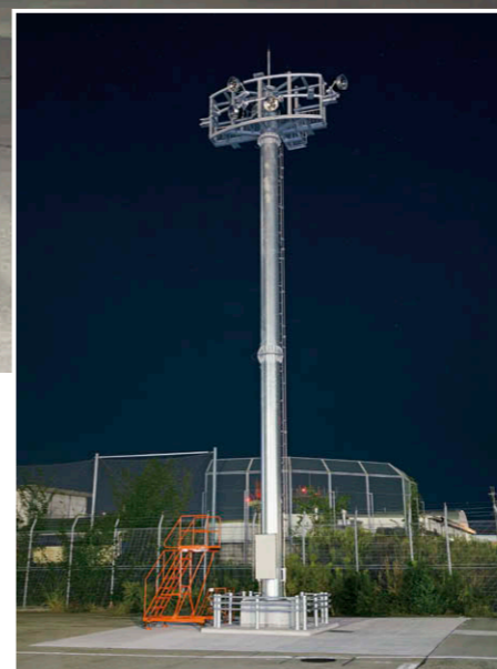
皿鉛めっき処理を施した照明塔灯柱。
