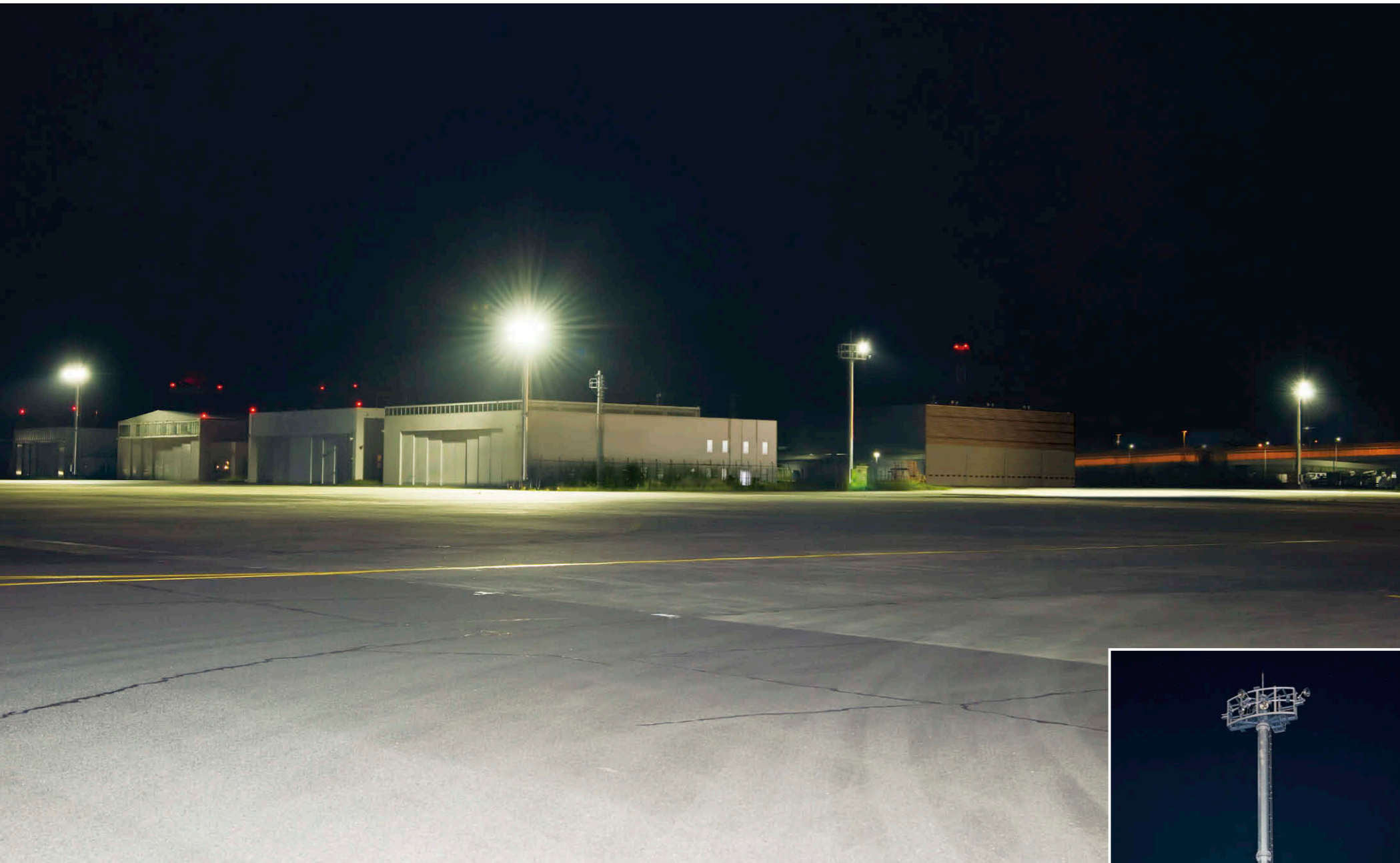
格納庫付近の照明 エプロン照明器具として専用開発したLED投光器①②を高さ17mの照明塔に設置し、エプロン照度基準に適合する明るさを確保。
