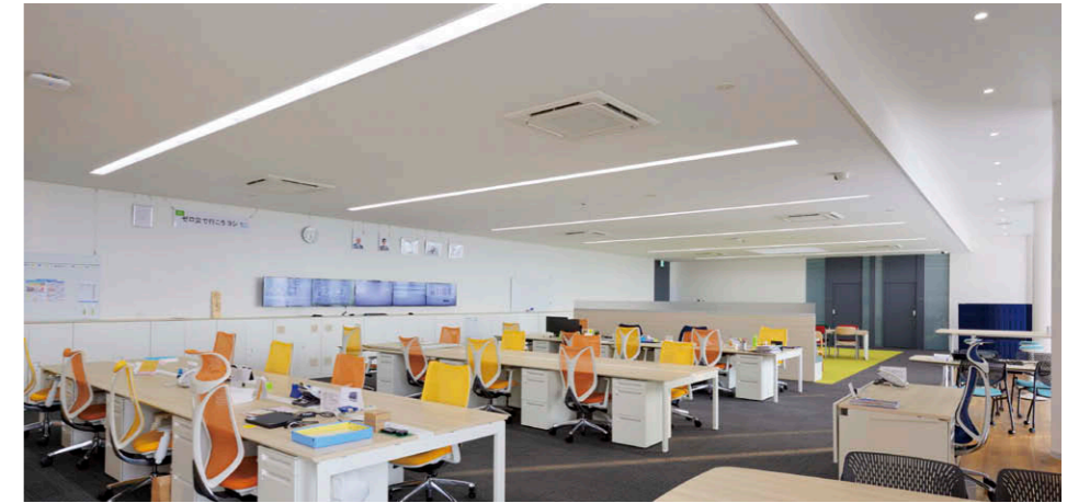
事務棟/2階事務室 3,200lmタイプの埋込形LEDベースライト(連結用)④を6灯1列とし、3.6mの間隔で8列配置。
