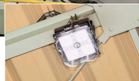
既設器具と同位置にリプレースした LED 高天井器具⑤
