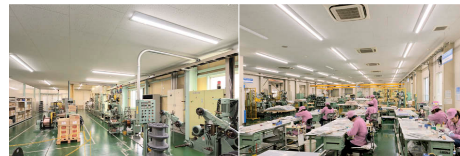
第2工場内 86形蛍光ランプ2灯器具に換えて 110タイプのLEDベースライト⑥を採用。
