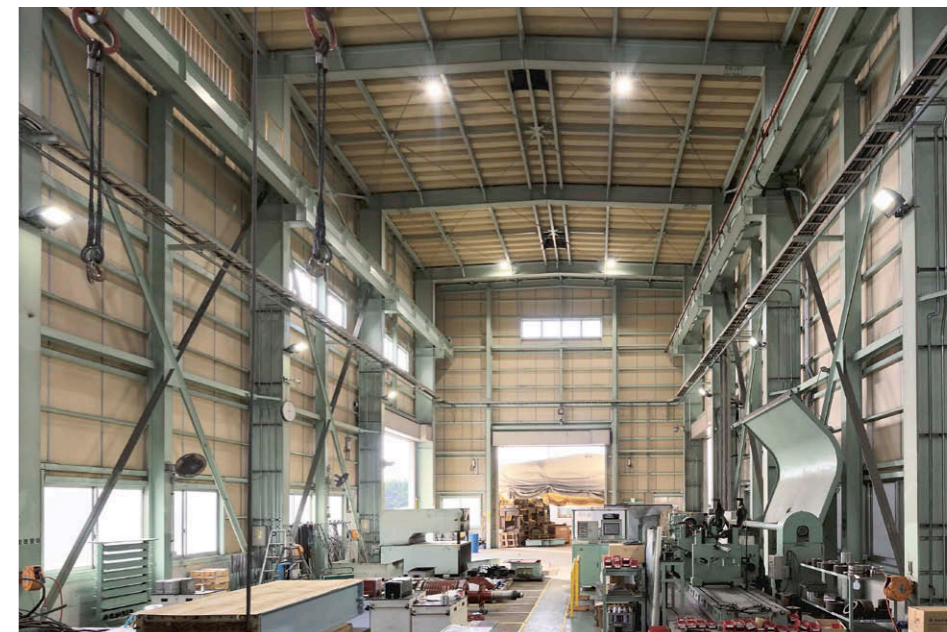
第1工場内 天井には400W形メタルハライドランプ器具相当のLED高天井器具①を、壁面には400W形水銀ランプ器具相当の小形角形投光器③を採用し、既存同等照度を維持。
