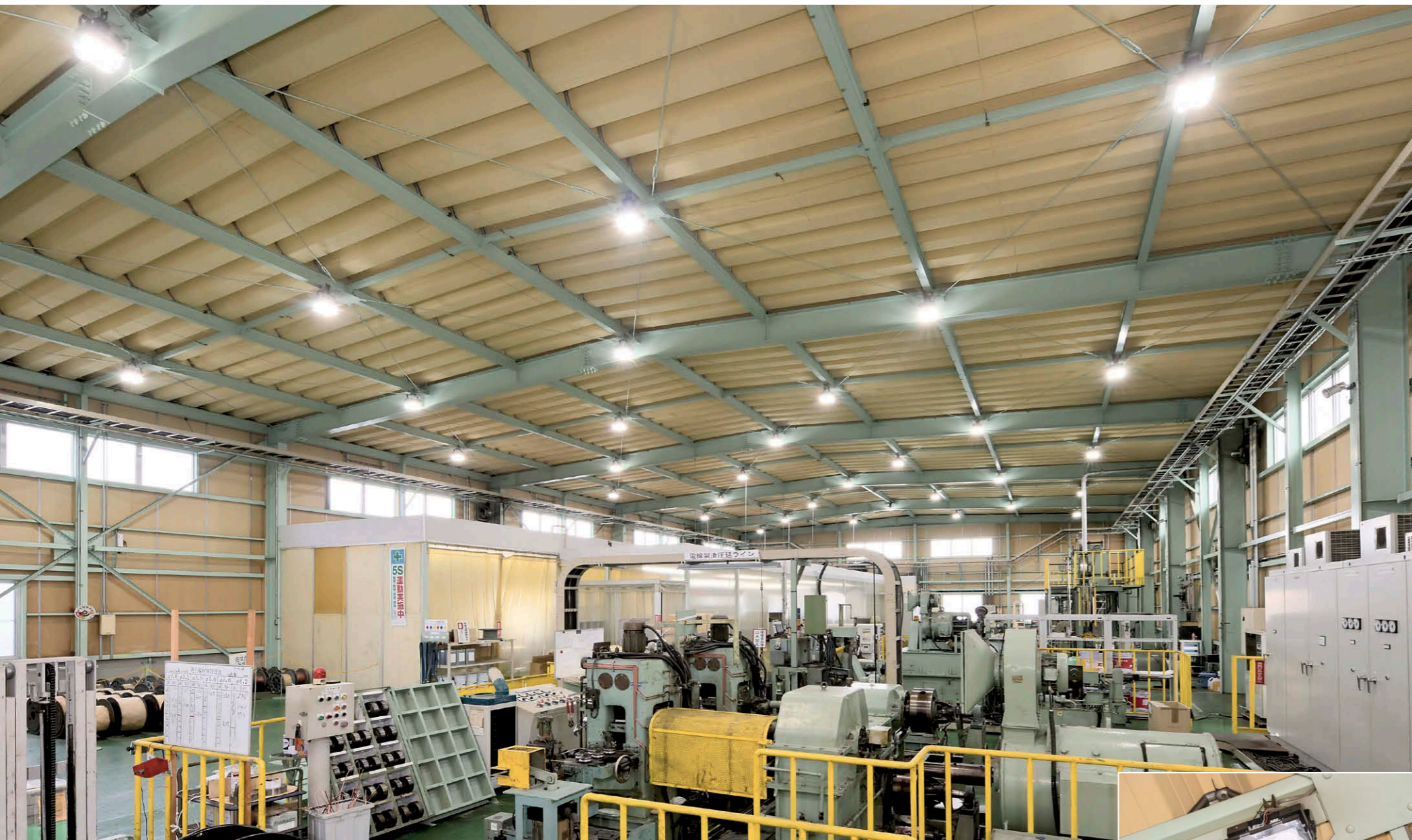
第2工場の照明 39台の400W形水銀ランプ器具に換えて、同数のLED高天井器具⑤を採用。既存と同等照度の明るい作業環境を確保。
