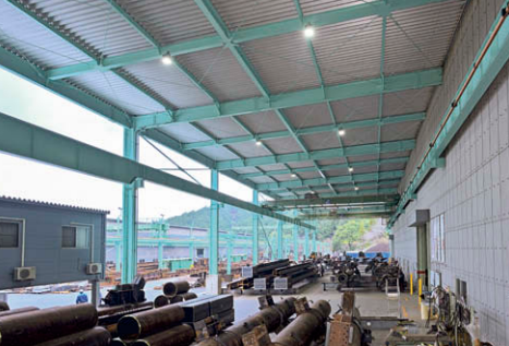
Eヤード 粉塵の多い特殊環境用で保護等級IP65性能を持つLED高天井器具④を17台配置。
