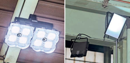
天井の梁に設置されたLED高天井器具①(左)と中央柱に設置されたLEDフラッドライト②(右)
