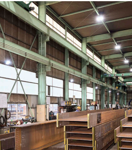
A棟側 壁面のLEDフラッドライト②は、省エネに配慮して1台ごとにON/OFF可能に。
