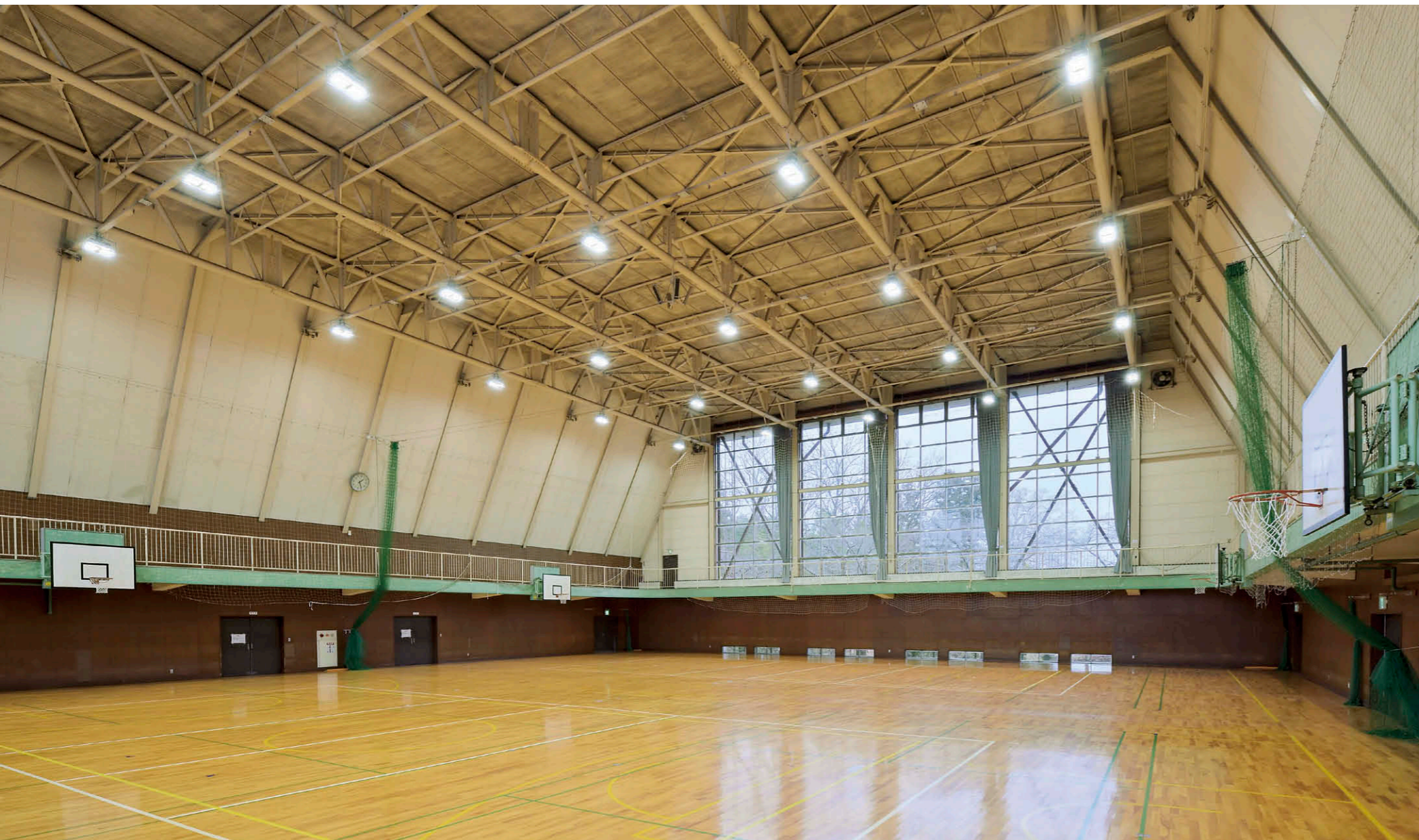
2階からアリーナ照明を望む。既設の水銀ランプ高天井器具からLED高天井器具軽量タイプ①②③に台数を削減して更新。
