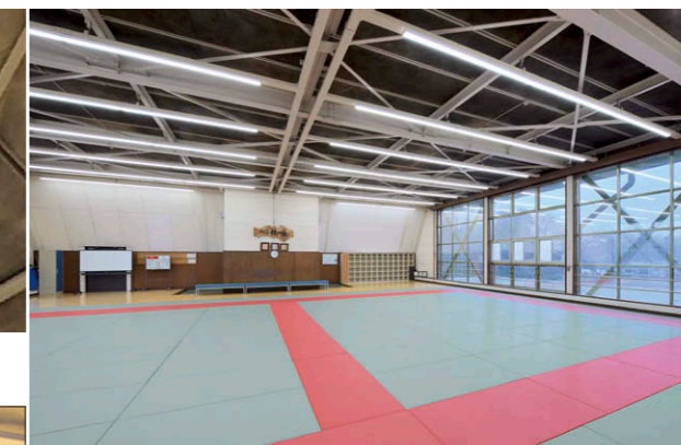
既設Hf86形器具からTENQOO110タイプW120④に更新の柔道場。
