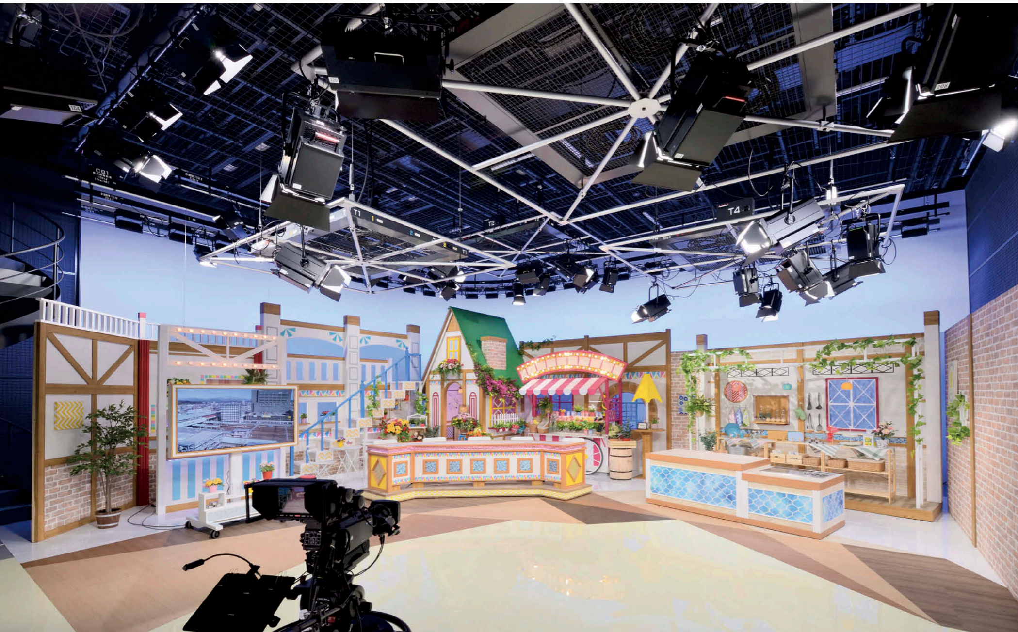
情報番組用セット LED スポットライト①②、LED ブロードライト③の仕込みが完了した状態。セット裏には LED ホリゾントライト④⑤を配置。
