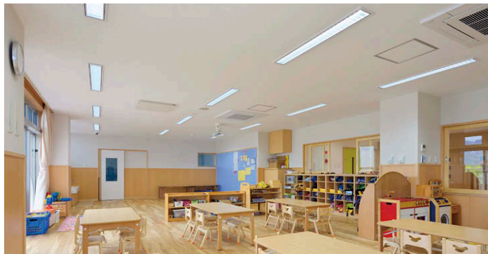
5歳児保育室 LEDベースライト埋込形のアルミルーバー付①の照明。
