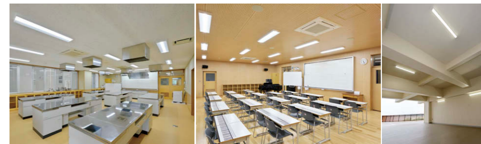
(左)家庭教室 (中)音楽教室 LEDベースライト直付形②を16台設置。(右)トレーニングスペース 台風対策として防湿・防雨タイプのLEDベースライト⑦を耐風圧用補強金具で固定。
