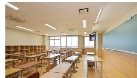
普通教室 高出力タイプ6,600lmのLEDベースライト②9灯とLED黒板灯③2灯を採用。
