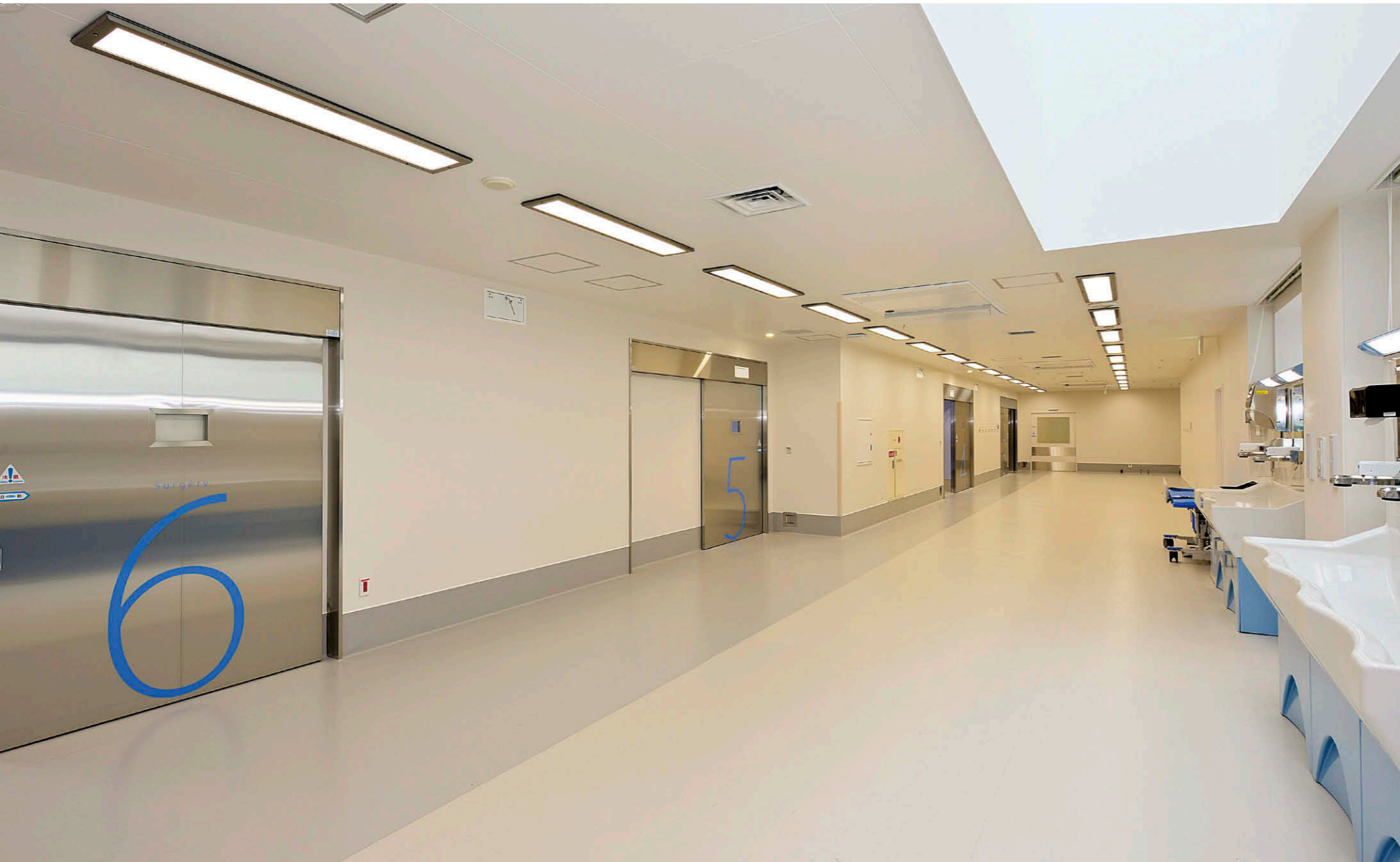
手術前ホール クリーン度を重視したLEDベースライトHACCP・クリーンルーム兼用形①の照明。
