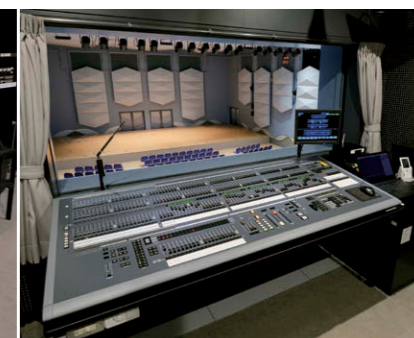
調光操作卓⑦（小ホール）
