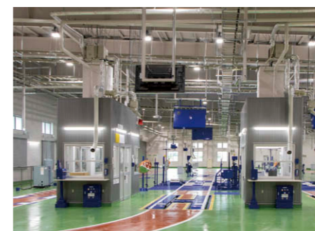
審査室 外壁面はTENQOO片反射笠器具②を、内部は埋込器具③を設置。
