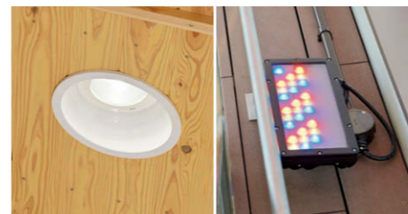
大屋根に設置したLEDダウンライト① ライトアップ用のフルカラーLED照明③
