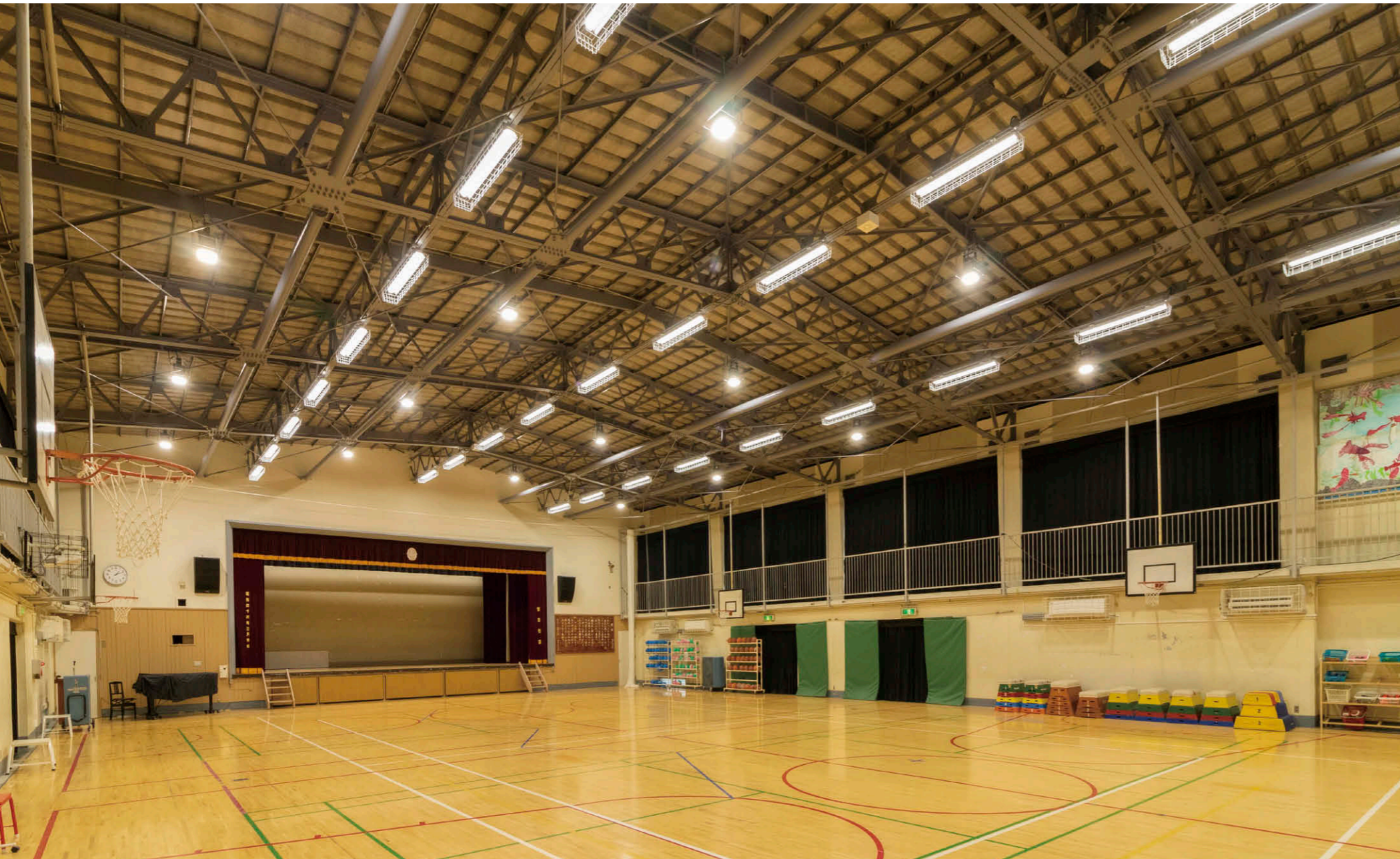
体育館入口サイドから見るLED高天井器具①とLEDベースライト②③全点灯の照明。
