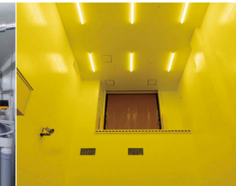
1階前室E 防虫対策として低誘虫タイプのイエロー光LEDベースライト③9灯を配置。
