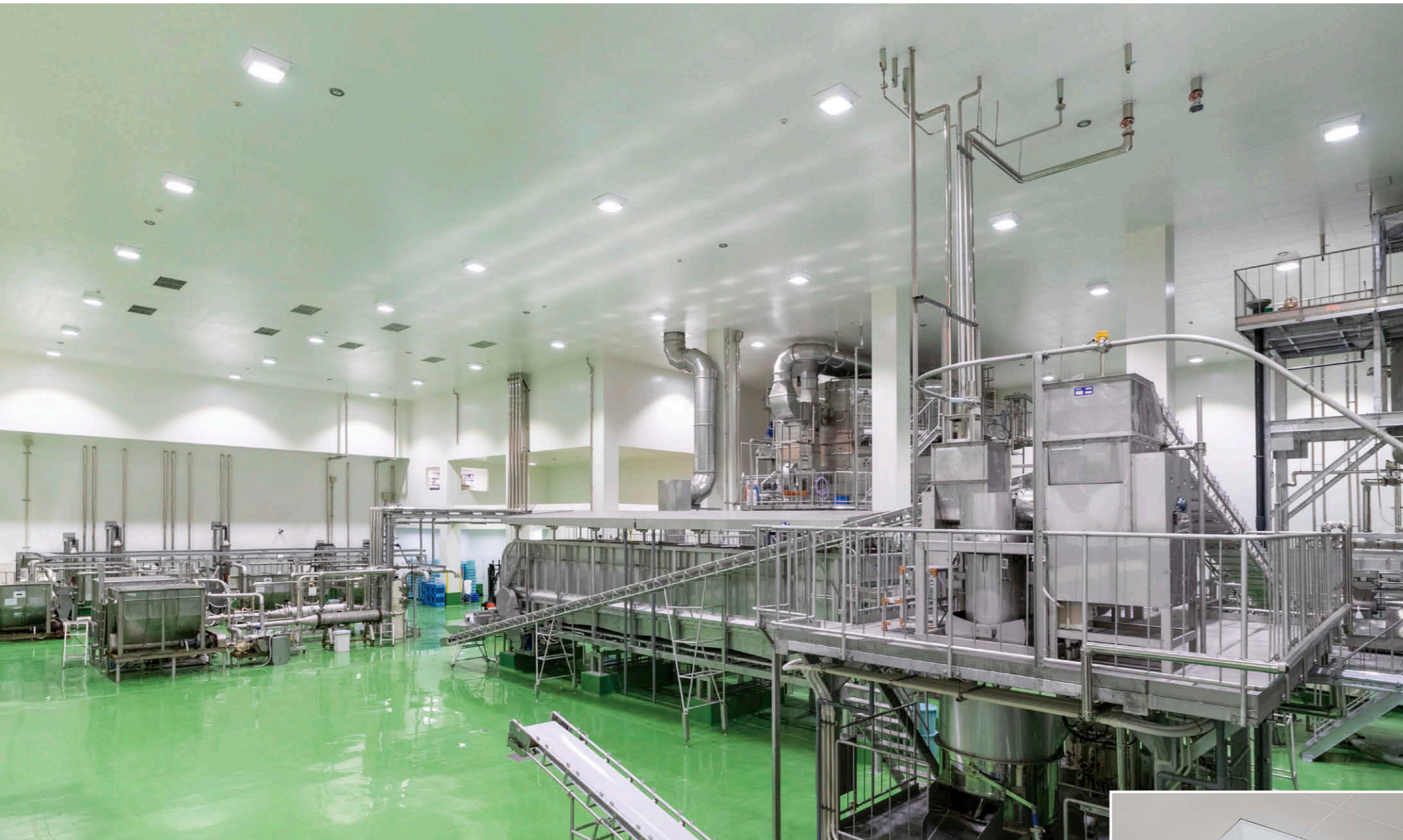
1階仕込み室の照明風景 グレアを抑える拡散カバー付きLED高天井器具①を一定の間隔で分散配置。光色5000Kによる明るい生産環境を創出。
