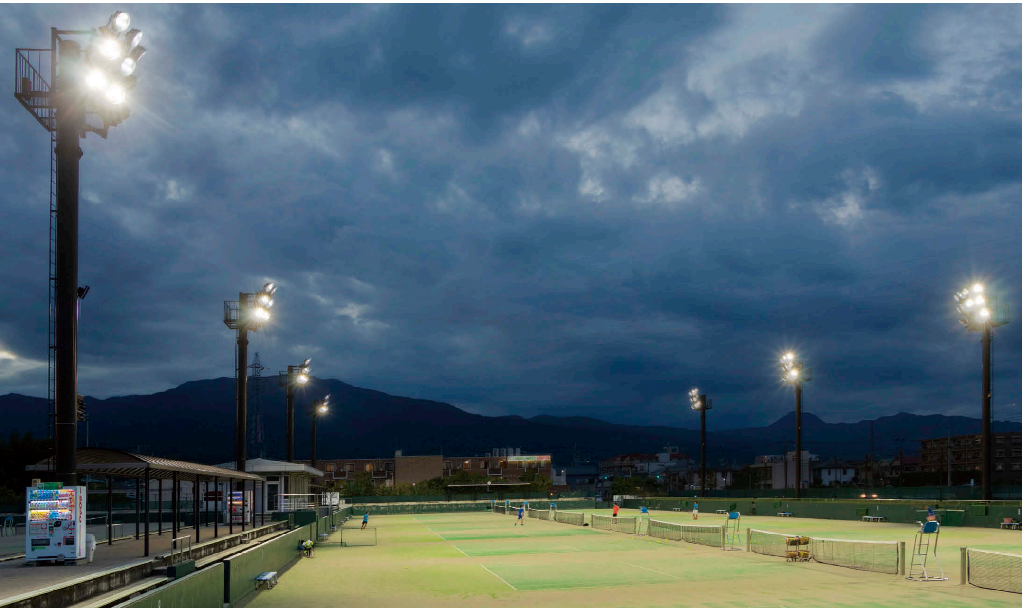
8 基の既設照明柱を活かして 8 面のテニスコートを LED 投光器①でムラなく明るく照射。
