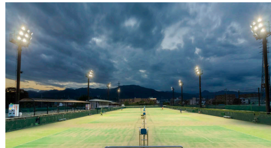
テニスコートのナイター照明 照明柱1基当たりLED投光器①9台×8基合計72台を設置。
