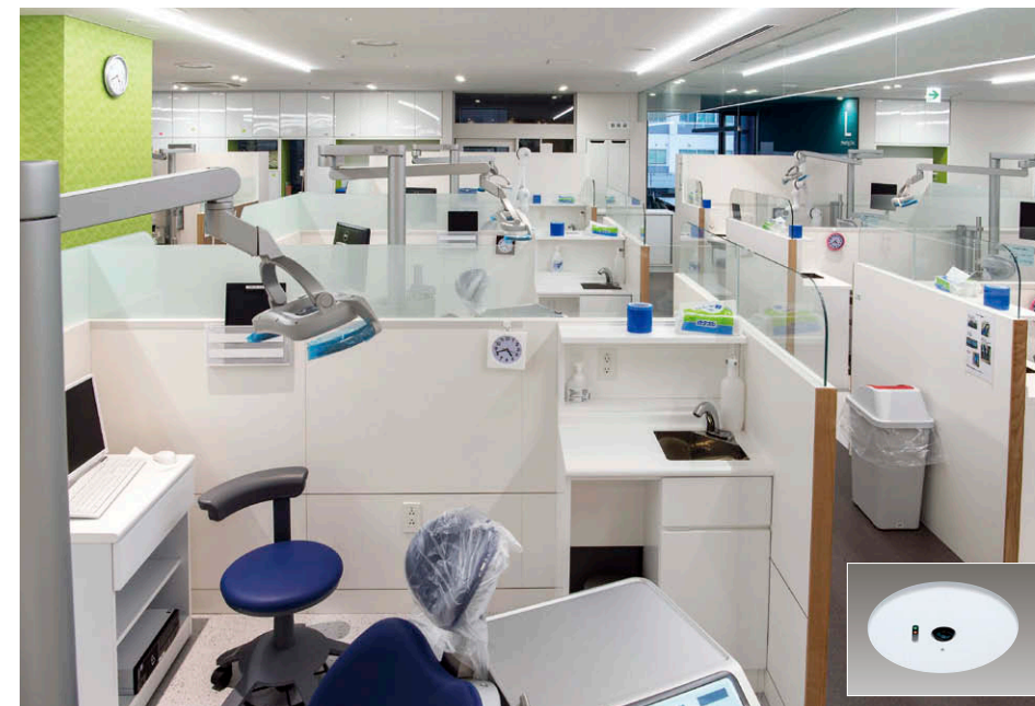
2階歯科大診療室 多機能画像センサー“スマートアイセンサーマルチ”により、各診療ブース内の人の在/不在および在員人数を認識し、照明・空調・換気を省エネ制御。
