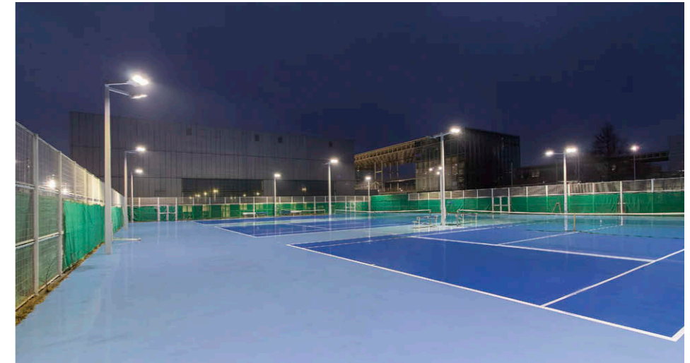
テニスコート 既設ポールに配置された LED テニス用器具④。前方配光レンズの採用により、近隣への光漏れを抑えながらテニスコート面を効率よく照射。
