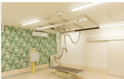
X線室のLED照明 (カバー付埋込器具調光タイプ)①
