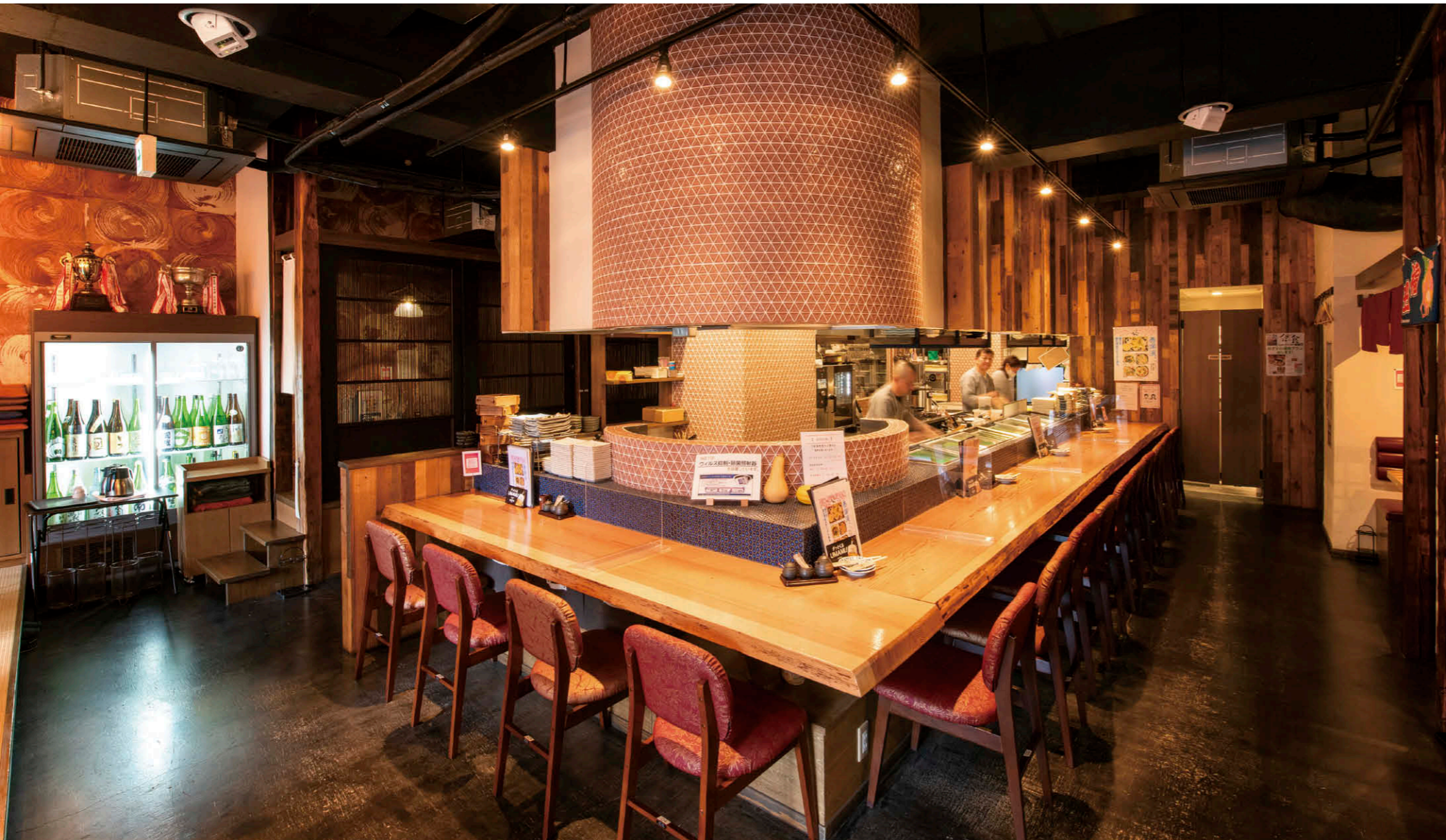
店内の窓側と奥側通路の天井にUVee①を2か所に設置 ウイルス抑制・除菌効果を発揮し、安心・安全な店内環境を。
