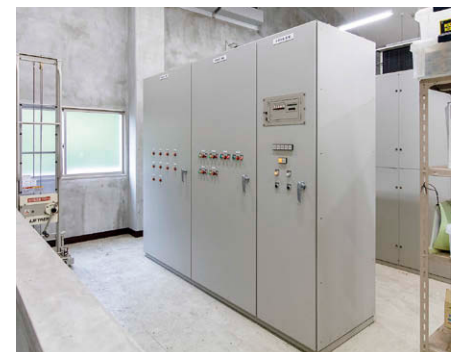
早坂町側の下り線坑口外部の専用棟に設置された照明制御（配電）盤。
